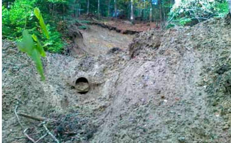
Poškodovana cestna infrastruktura
